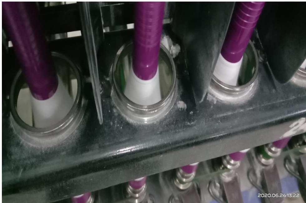
Lampiran 6 kondisi ring flange lama dan baru
